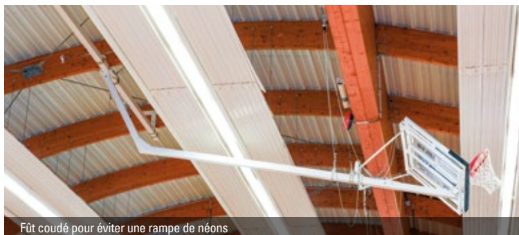
Fût soudé pour éviter une rampe de néons
