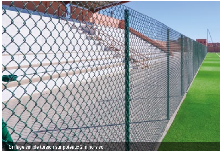
Grillage simple torsion sur poteaux 2 m hors sol
